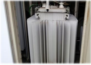
変圧器(トランス)
