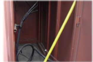
高圧ケーブル
